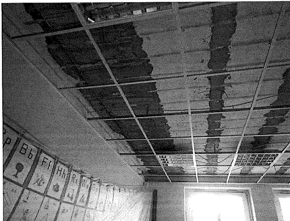
Bild 2: Deckenansicht mit Vollbetonstreifen neben der tragenden Trennwand.
