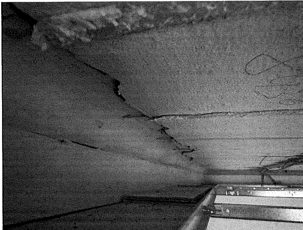
Bild 4: wie vor, als Detailaufnahmen – die Rissufer zeigen einen Höhenversatz.
