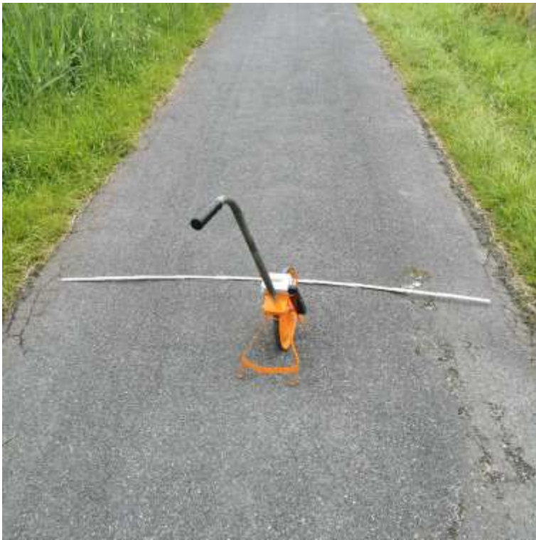
Bild 9 (Foto: Schmidt) Station +148 Versackung
