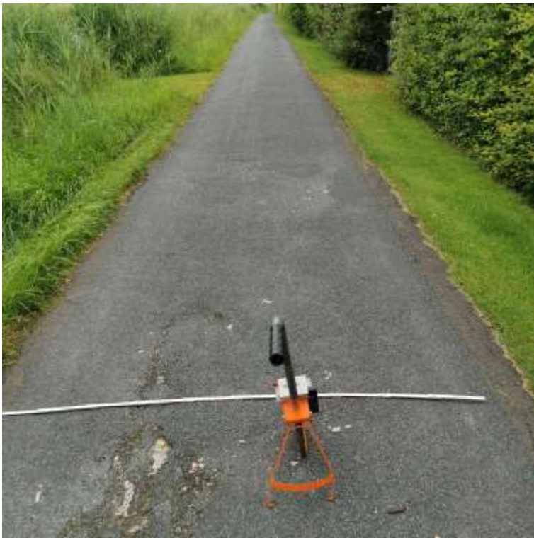
Bild 13 (Foto: Schmidt) Station +353 ausgefahrenen Bereiche
