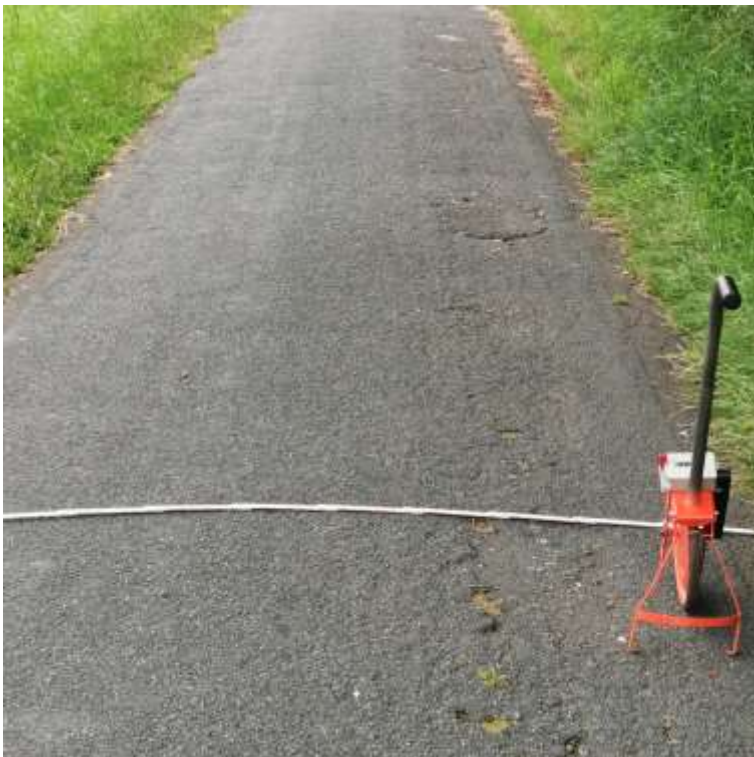
Bild 12 (Foto: Schmidt) Station +323 Grasdurchwuchs
