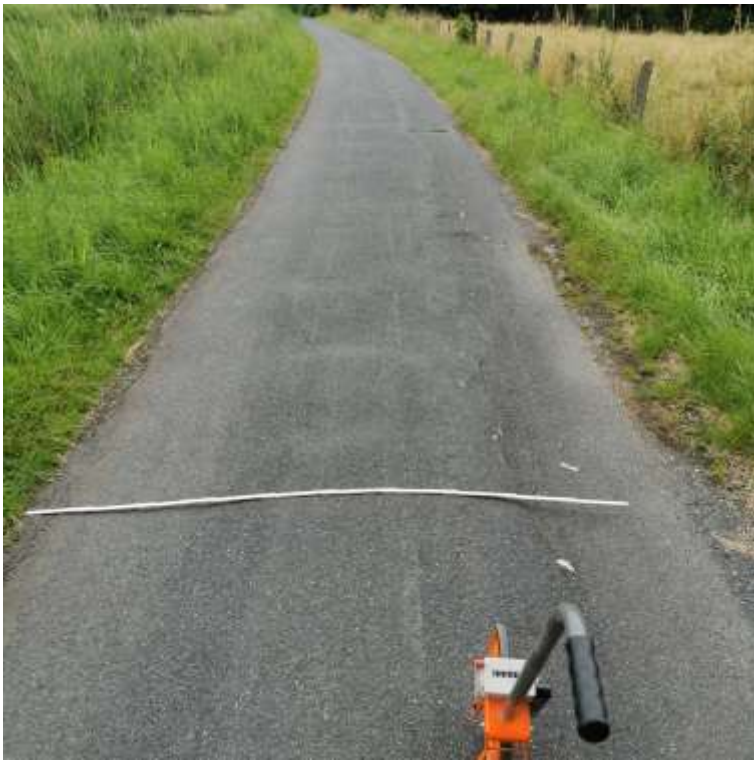
Bild 7 (Foto: Schmidt) Station +80 Versackungen
