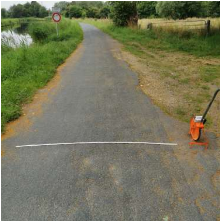
Bild 5 (Foto: Schmidt) Station +48 ausgefahrenen Bereiche
