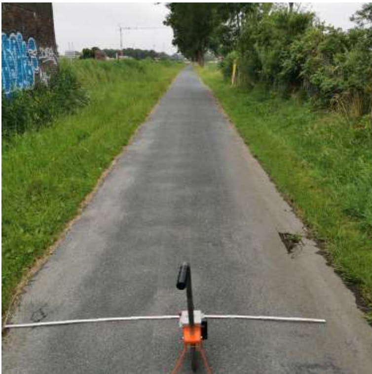
Bild 18 (Foto: Schmidt) Station +700 Grasdurchwuchs
