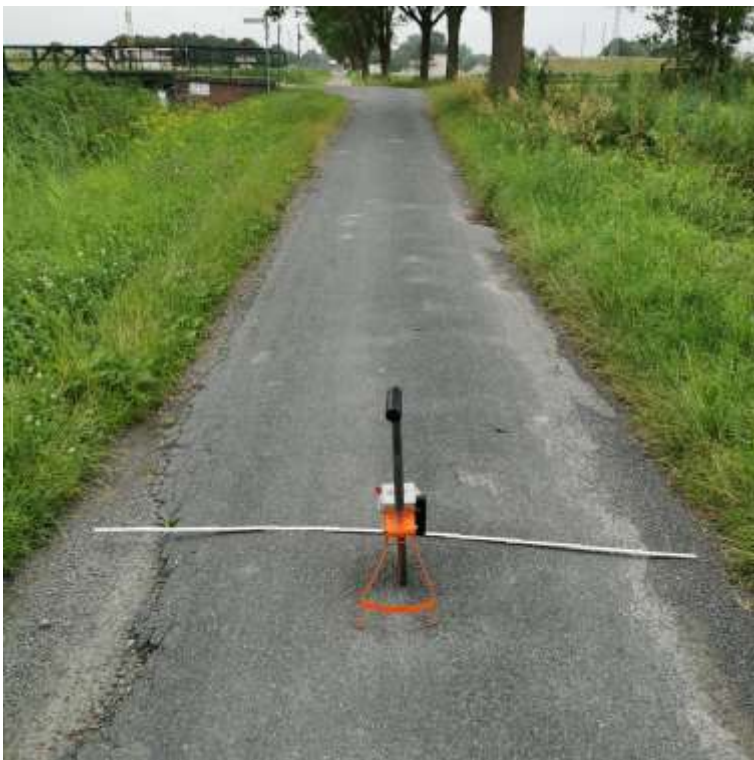
Bild 20 (Foto: Schmidt) Station +817 Abbrüche
