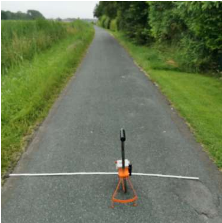
Bild 11 (Foto: Schmidt) Station +306 Versackung
