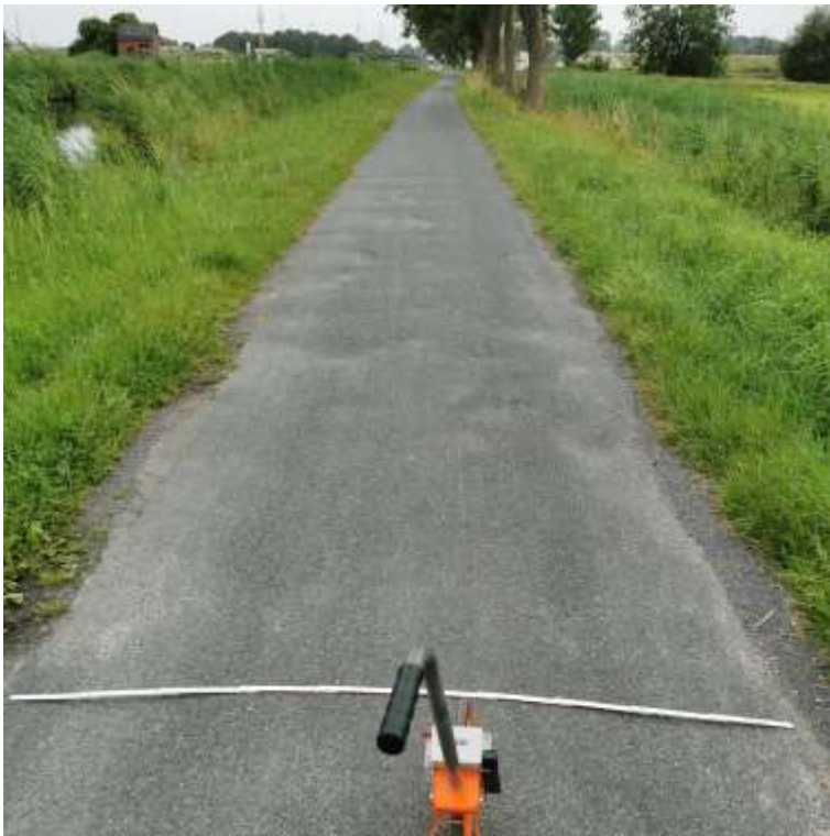
Bild 19 (Foto: Schmidt) Station +747 Versackungen
