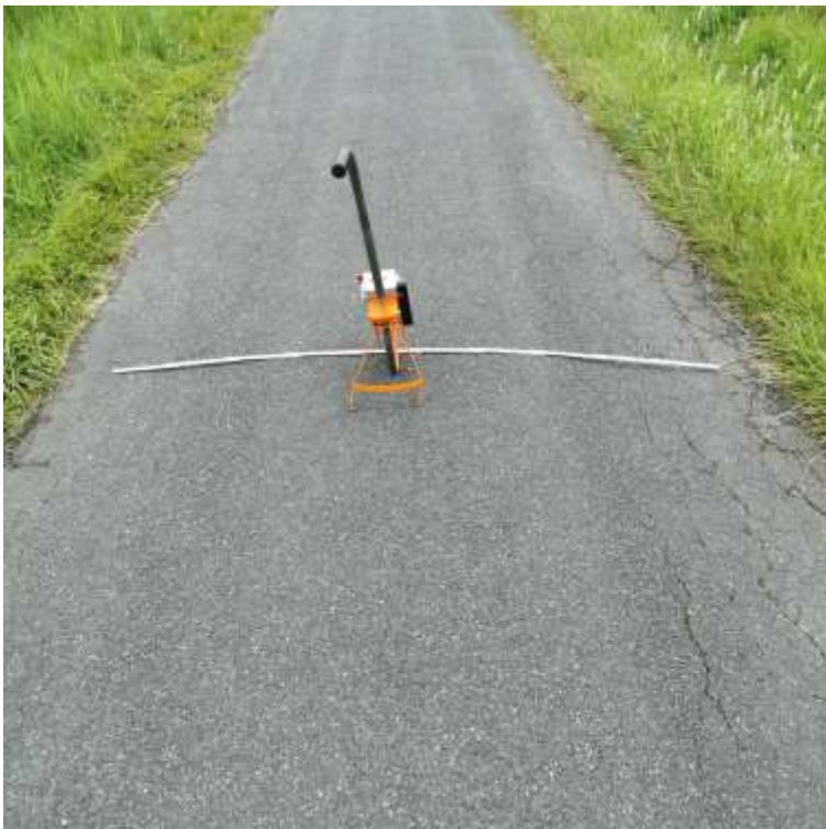
Bild 8 (Foto: Schmidt) Station +112 Rissbildung
